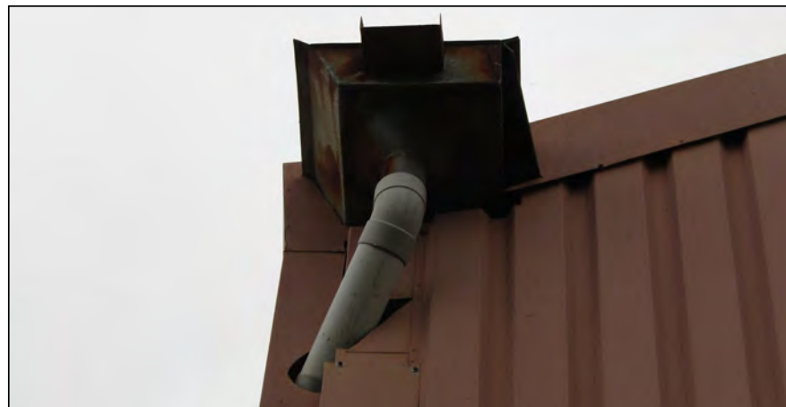
Figuur: via openingen bij regenpijpen kunnen vogels zoals spreeuw, witte kwikstaart of zwarte roodstaart, zich toegang verschaffen en broeden in het gebouw.
