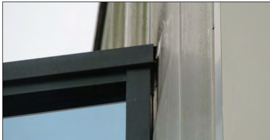
Figuur: opening aan voorzijde gebouw aan Arkelsedijk waar vleermuizen mogelijk in kunnen kruipen en verblijven .
