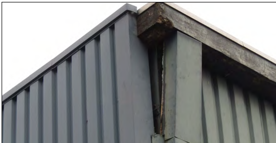
Figuur: de bebouwing aan de Arkelsedijk heeft aan de rivierzijde openingen, waaronder loszittende gebouwdelen, waardoor vogels en vleermuizen zich toegang kunnen verschaffen tot het gebouw.
