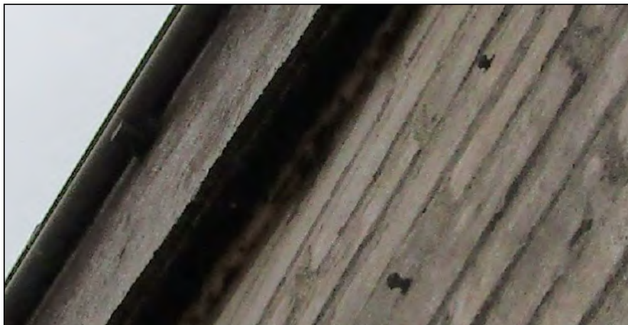
Figuur: een deel van de bebouwing langs de Linge heeft een spleet onder de dakrand waar vleermuizen in zouden kunnen kruipen en verblijven.
