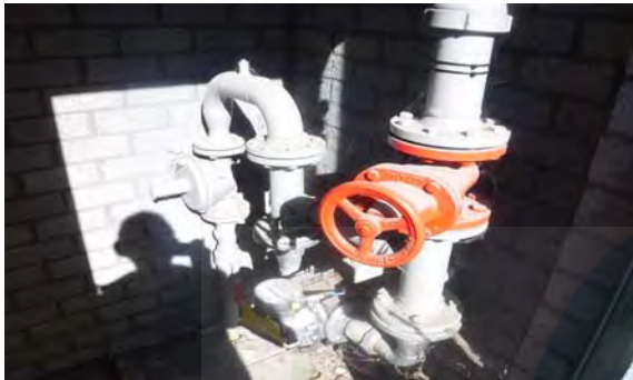
Asbest flenspakkingen gasmeter ruimte
