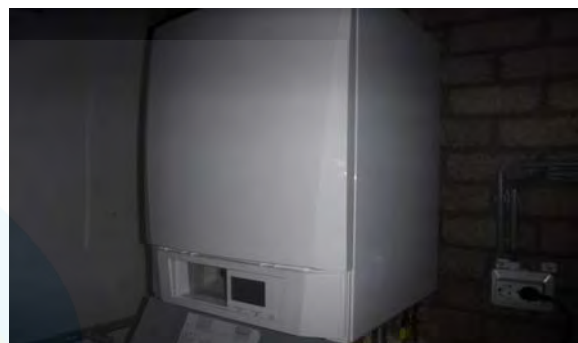
C.V. ketel niet asbestverdacht
