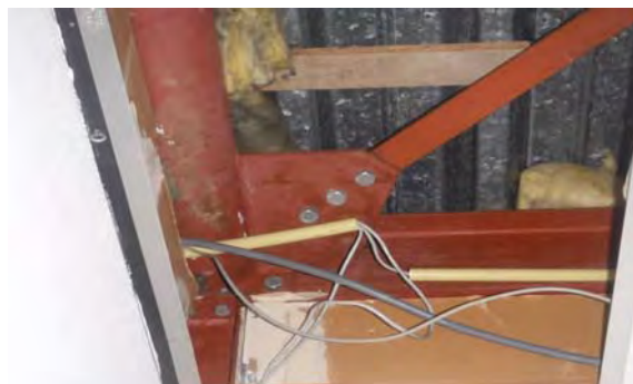
Staalconstructie boven systeemplafond 1e verdieping
