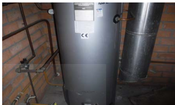
Gasboiler niet asbestverdacht
