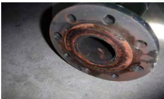
Losse pakking c.v. ruimte niet asbestverdacht
