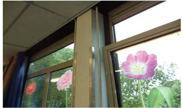
Asbesthoudende plaat rondom verticale kolommen
