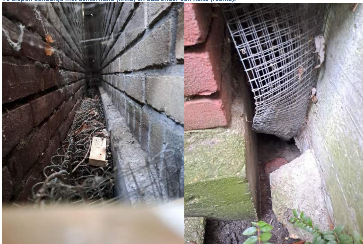
Ruimte achter de achterwand van het schuurtje (links) en de opening van de holte onder het schuurtje (rechts),
