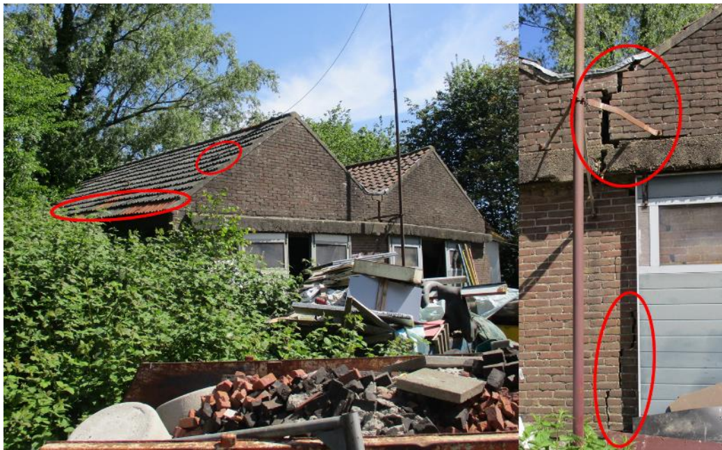
Figuur 5 Veel pannen van de schuur achter op het erf liggen scheef of zijn iets verzakt, waardoor openingen aanwezig zijn die toegang bieden tot ruimtes onder de pannen (links). Door de verzakking zijn in de muren spleten ontstaan (rechts).
