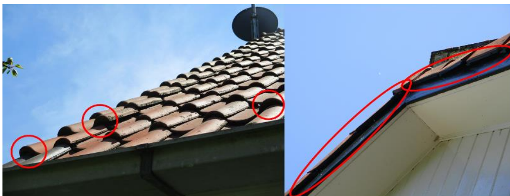
Figuur 4 Op de voorste woning op het erf zijn scheefliggende pannen aanwezig (links). De kantpannen van de woning kieren, waardoor openingen aanwezig zijn tussen de kantpannen en het boeiboord (rechts).
